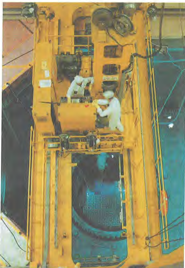
Plataforma de recarga y vasisa de la central nuclear Vandellós II
