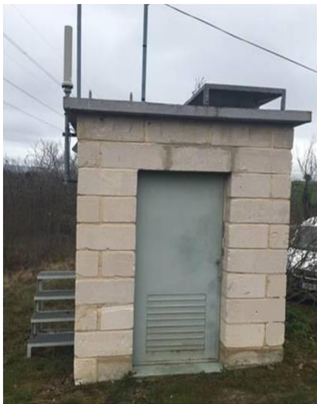
Figura 8. Caseta con equipo de toma de muestras de depósito total
