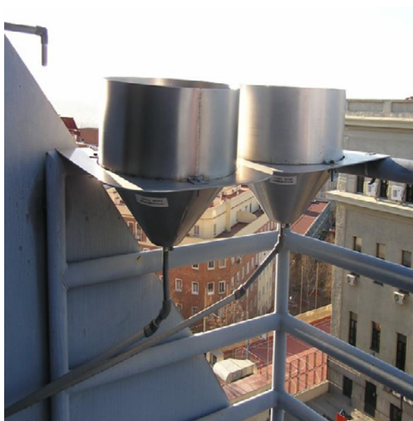
Figura 5. Colectores de superficie con codos en los conductos superiores a 135^\circ .
