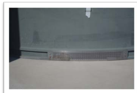
Detalles de la rejillas de los conductos de ventilación superior e inferior del HI-STORM 100Z en el ATI de J. Cabrera
