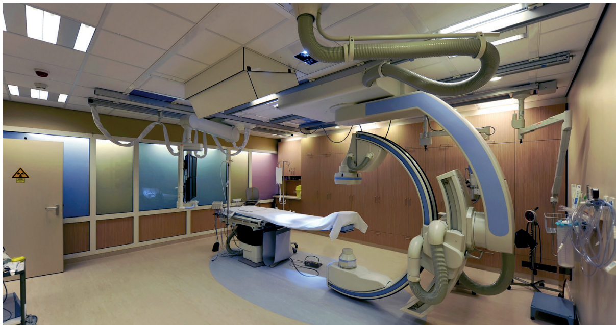
Figura 12.a. Aspecto de una sala dedicada a intervencionismo, donde se aprecia el arco en forma de C que agrupa enfrentados tubo y detector de rayos X.
