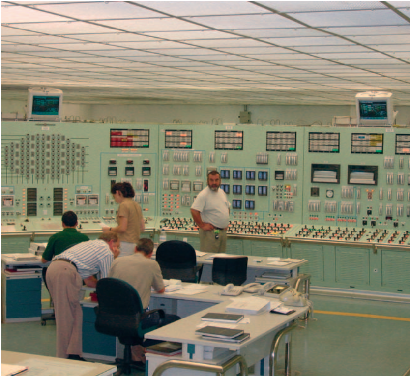
Sala de control de una central nuclear.
