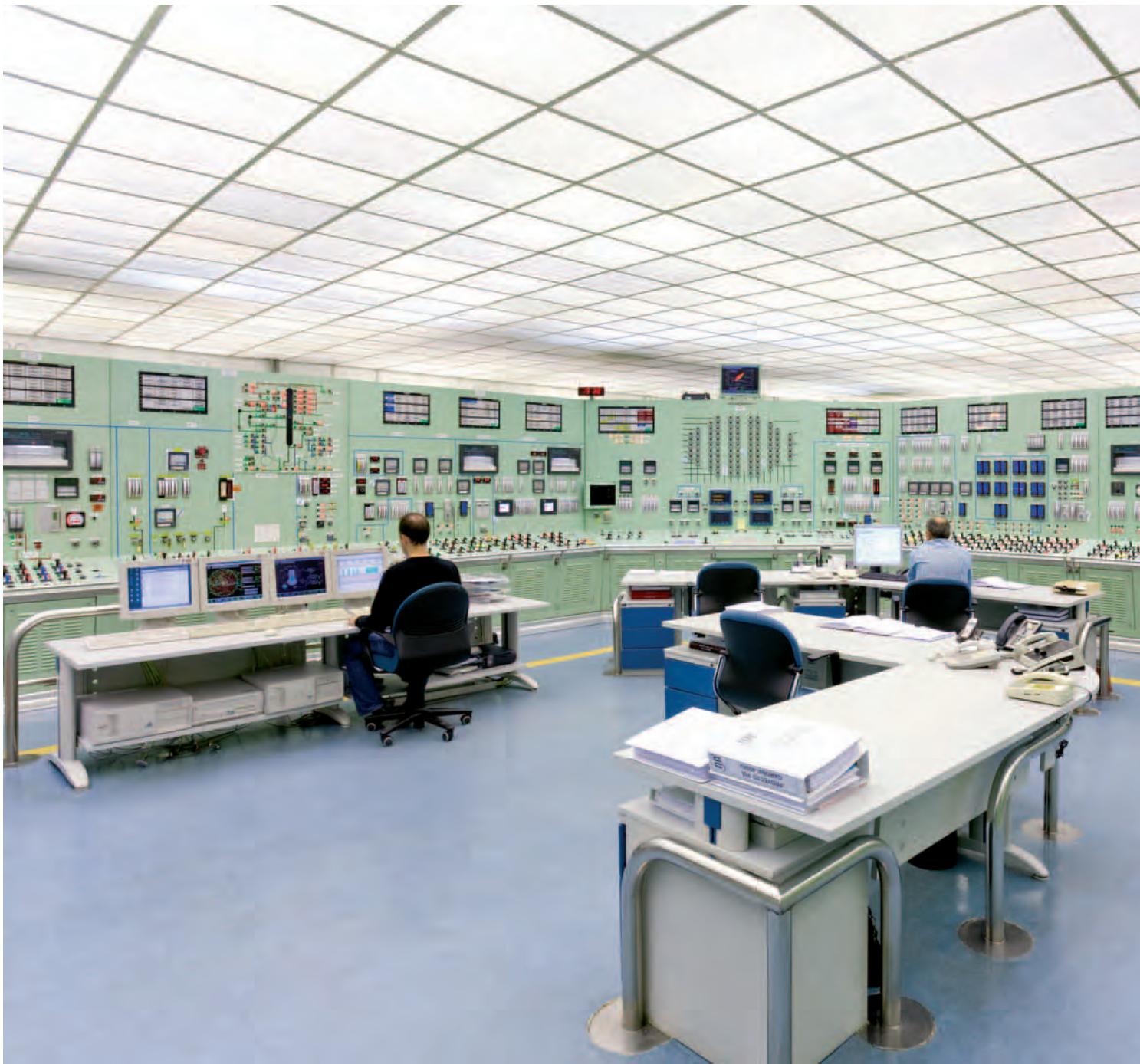
Simulador réplica de la sala de control de Santa María de Garoña, instalado en el emplazamiento de la central.
